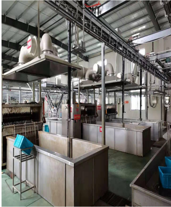
屠宰间废气集气装置
