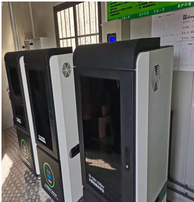
污水总排口在线监控设备
