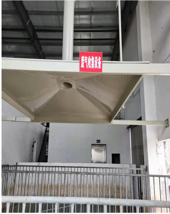
待宰间废气集气装置
